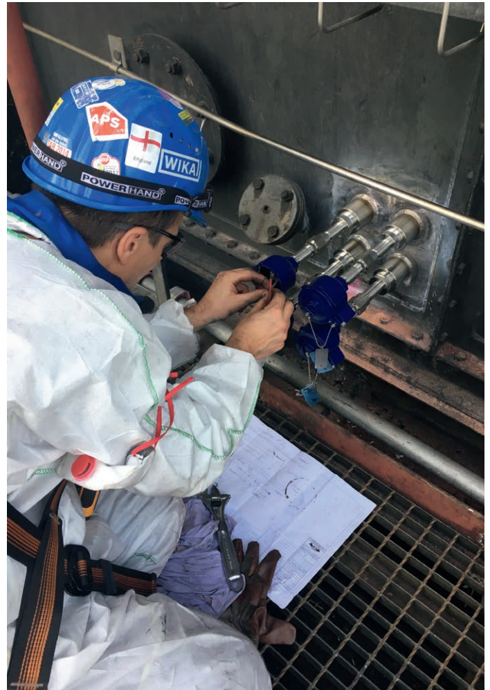
Transmisión de señales y prueba de funcionamiento
